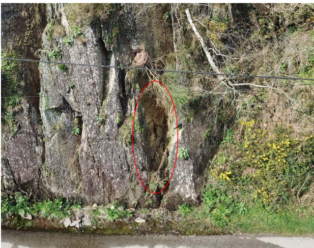
Zone de départ de l'éboulement de janvier 2020
