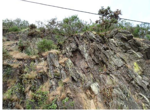
Rupture de surplomb
